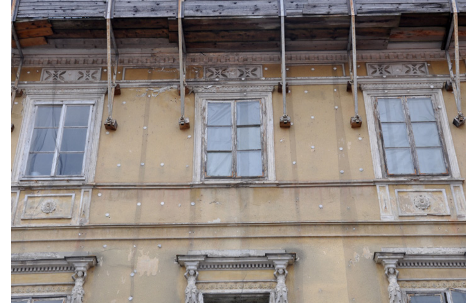
V Društvu Novo mesto se borimo, da bo pročelje vse bolj propadajočega Narodnega doma še dolgo zakrivala zaščitna mreža. Foto: Tomaž Golob, 2016.
